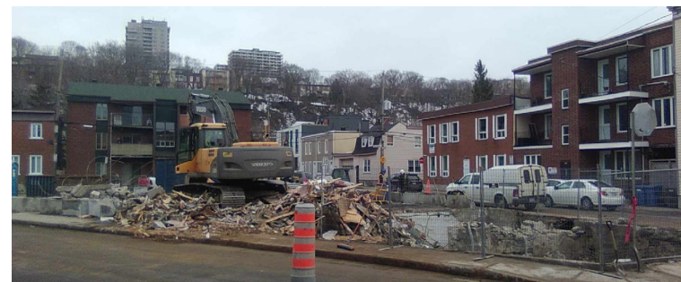
Démolition du bar le Kirouac pour faire place à la Coop. Image : Guillaume Béliveau Côté
